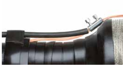
Połączenie z wyprowadzeniem uziemienia
